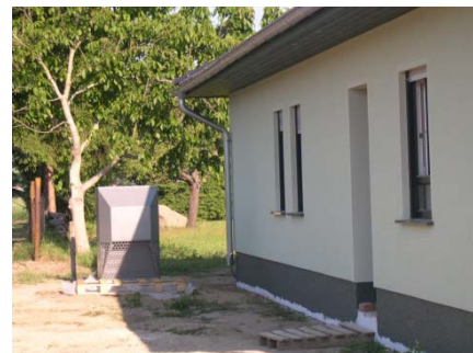
Wohnhaus mit Luft-Wasser-Wärmepumpe
